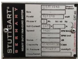
Foto Nameplate Fan Blower
