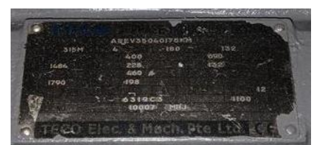
Foto Nameplate Motor
